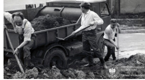
Ogólnopolski Czyn Społeczny z 12 maja 1974 r. Funkcjonariusze przygotowali teren pod budowę bloku dydaktycznego i pracowali na rzecz Fabryki Samochodów Małolitrażowych w Tychach
