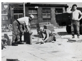
Prace przy przebudowie placu apelowego w jednostce ZOMO w Katowicach-Piotrowicach, sierpień 1965 r.
